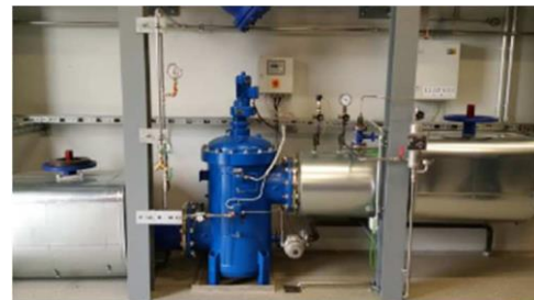
Filtro en funcionamiento
