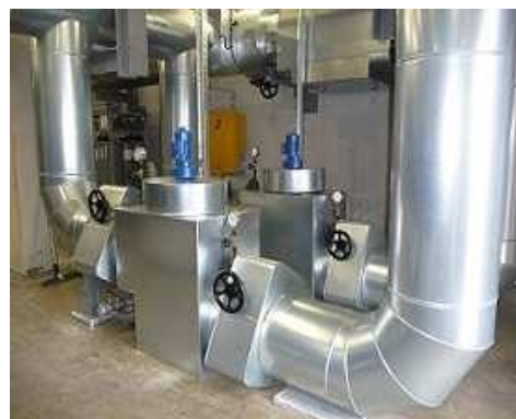
Filtro funcionando en paralelo, con aislamiento
