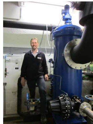
Franz Harlander neben der Installation des BOLLFILTER Automatik in der Maschinenhalle des Kraftwerkes Schwarzach
