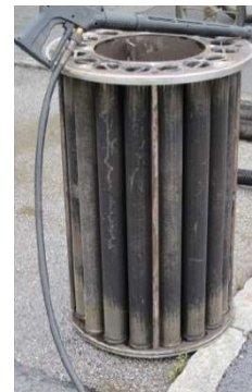
Bei der Revision ausgebautes und begutachtetes Filterelement
