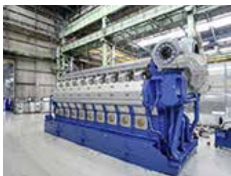
Imágenes de izquierda a derecha: Central eléctrica, Texas; DF Motor Wärtsilä
