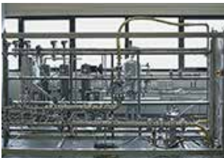
Banco de pruebas de gas BOLL & KIRCH
